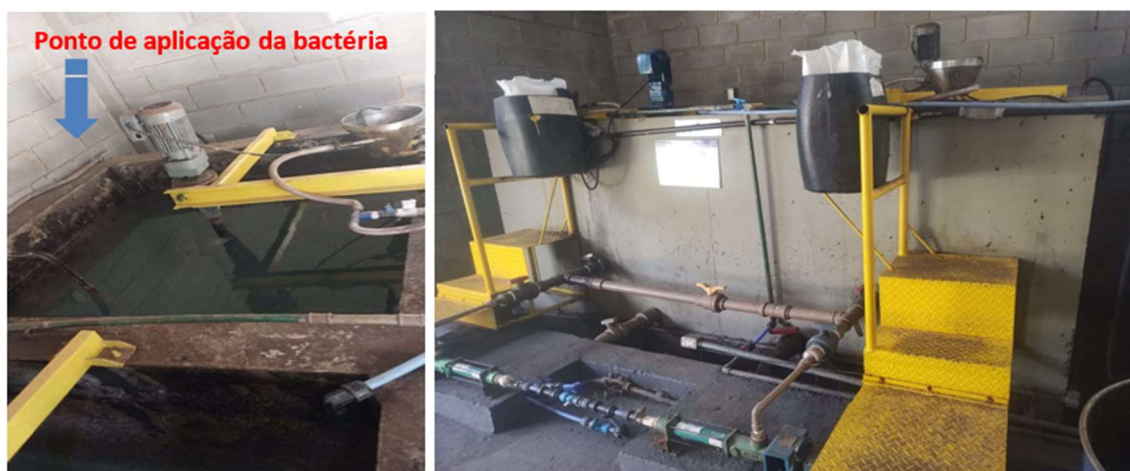
Figura 9 - Tanque de preparo da solução de Polímero existente na unidade
