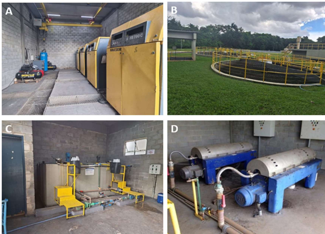
Figura 5 - Etapas seguintes para a unidade de tratamento do lodo da ETE Salto do Guimarães, sendo A Casa de sopradores, B adensadores etapa de tratamento do lodo, C tanque de preparo da solução de polímero para etapa de tratamento do lodo e D centrífugas
