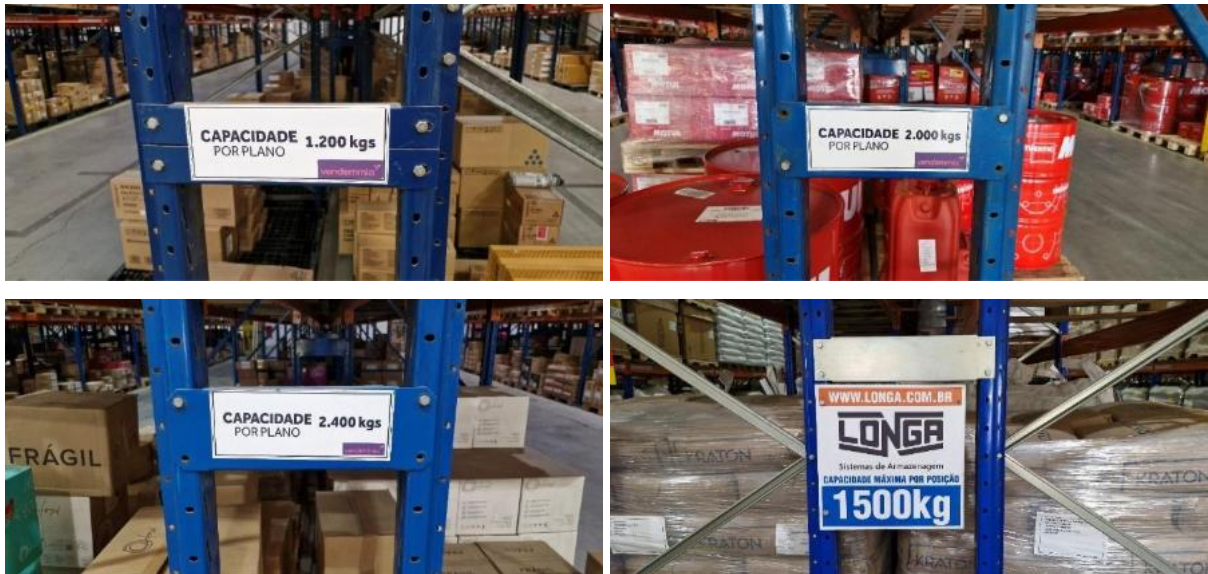
Figura 25 – Verificação das placas de identificação
