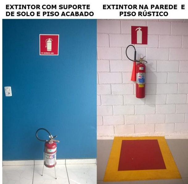
Figura 3: Extintor de incêndio instalado conforme Norma Fonte: Elaboração própria
