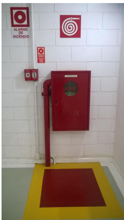
Figura 6: Hidrante instalado conforme IT 20 (2011) Fonte: Elaboração própria
