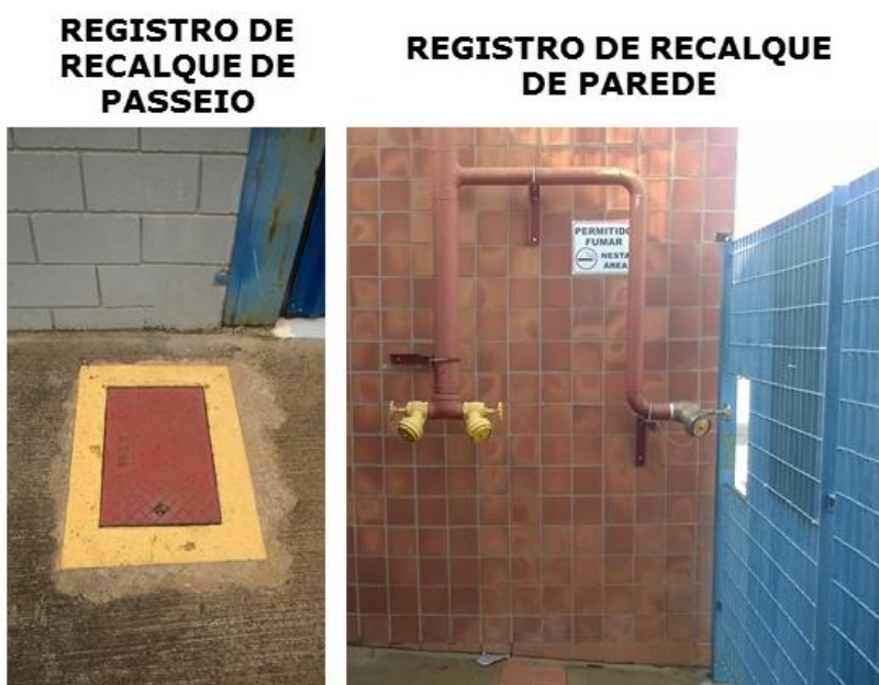
Figura 8: Registros de Recalque Fonte: Elaboração própria
