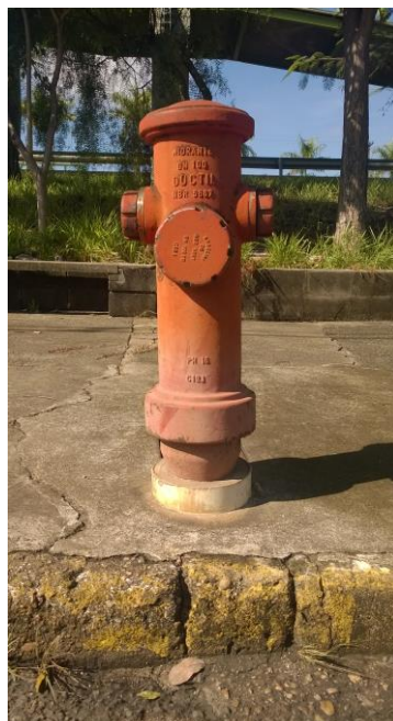
Figura 7: Hidrante urbano tipo barbará com vazão menor que 1000 L/m Fonte: Elaboração própria
