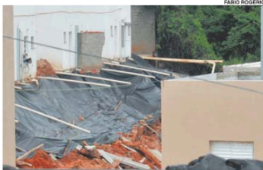
Um muro desabou e interditou apartamentos neste condomínio
