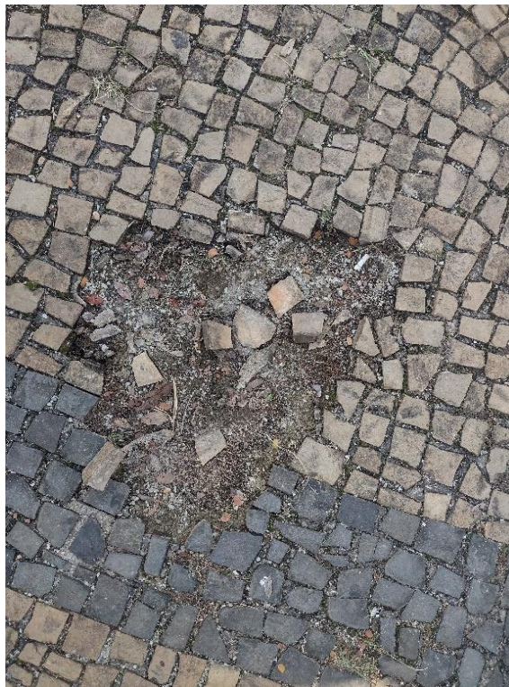
Figura 31 — Observação da deterioração da Praça Frei Baraúna
