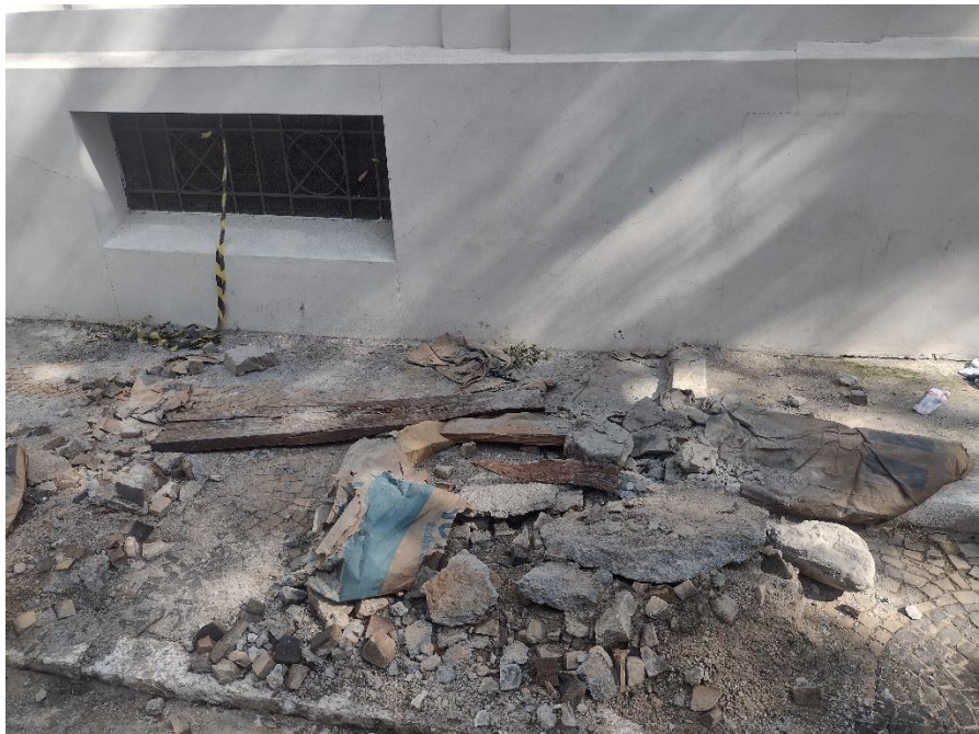
Figura 33 — Observação da deterioração da Praça Frei Baraúna
